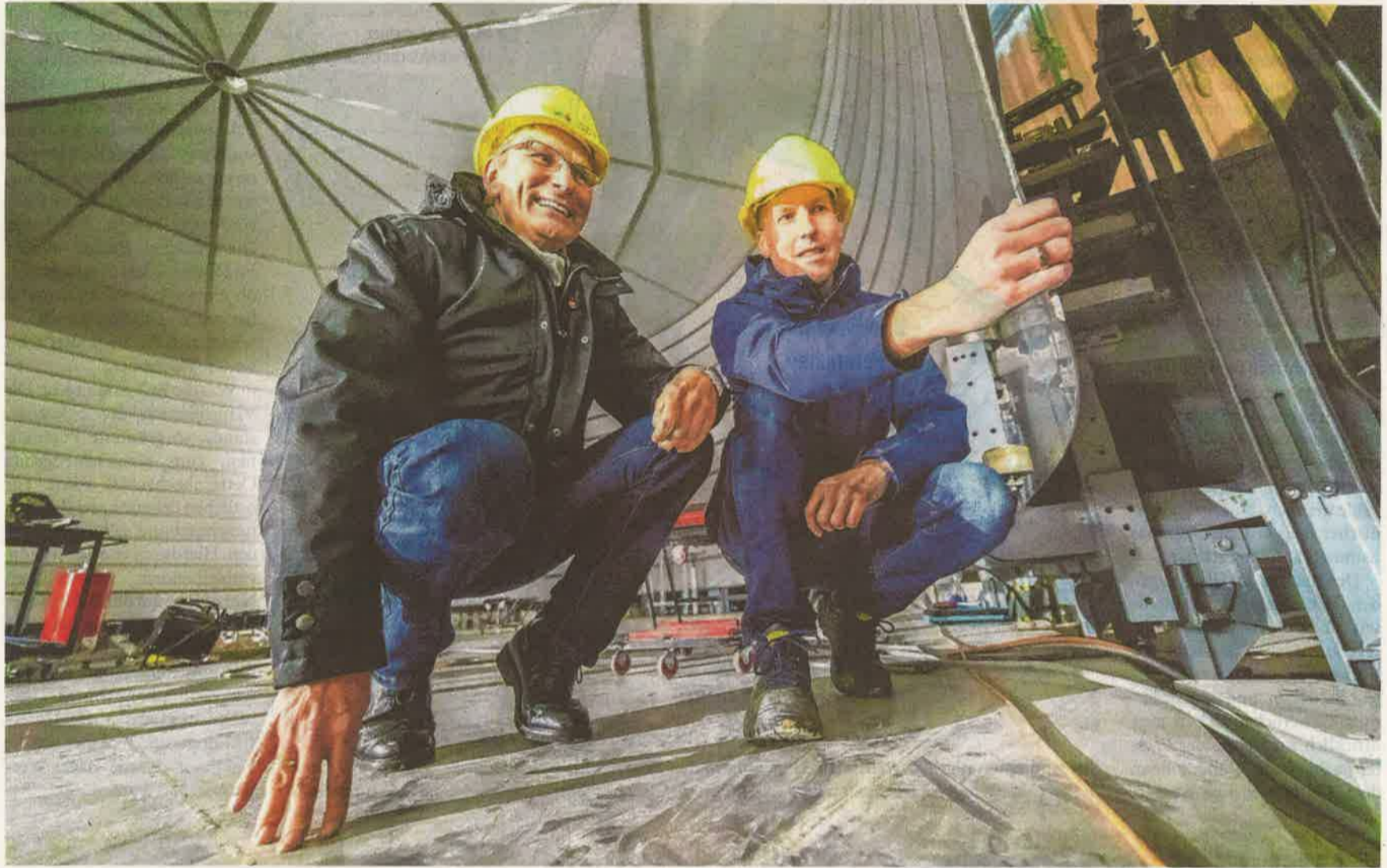
Spitzentechnologie im Einsatz: Stadtwerkegeschäftsführer Jörg Karlikowski (links) und Bereichsleiter Dirk Kornhoff nehmen die Arbeit des Roboters (rechts) in Augenschein und sind dafür ins Innere des Edelstahlbehälters geklettert, der von der Maschine Stück für Stück zusammengesetzt wird.
