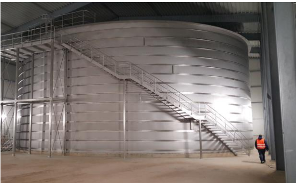
Abb.31 Trinkwasserbehälter mit 5000 m 3 im Betrieb
