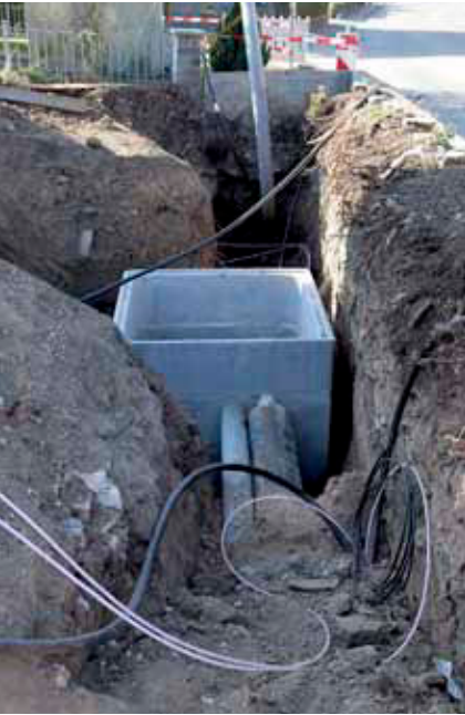
Gerade in Arbeit ist ein 1,4-Kilometer-Netz. Im Jahr 2018 wurden 30 neue Anschlüsse gebaut, 2019 sollen weitere 30 folgen.
