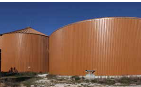
Mit seiner Biogasanlage, die seit 2009 störungsfrei läuft, ist Abele sehr zufrieden. Der Fermenter (links) fasst 1.800 m 3 und hat ein integriertes Gasdach. Gleich daneben steht der Nachgärer mit 2.200 m 3 .
