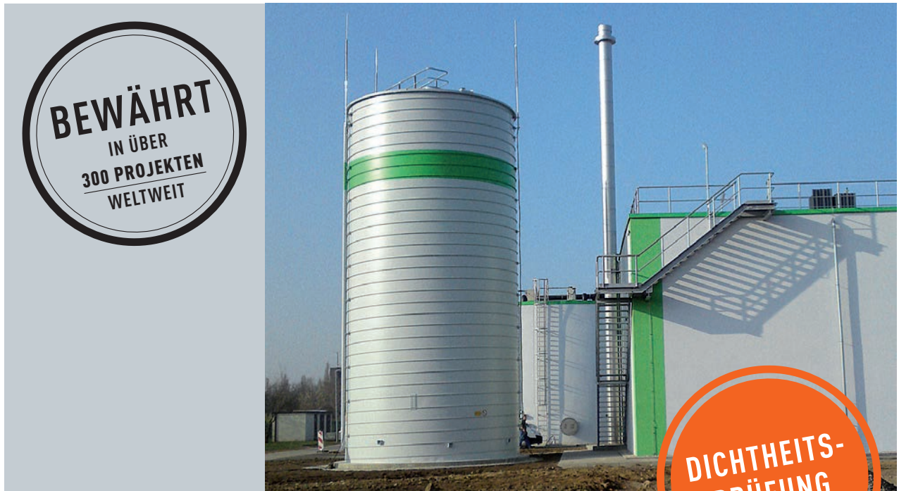
Industrieanlage: LIPP Gasspeicher (1.100 m 3 Volumen)
