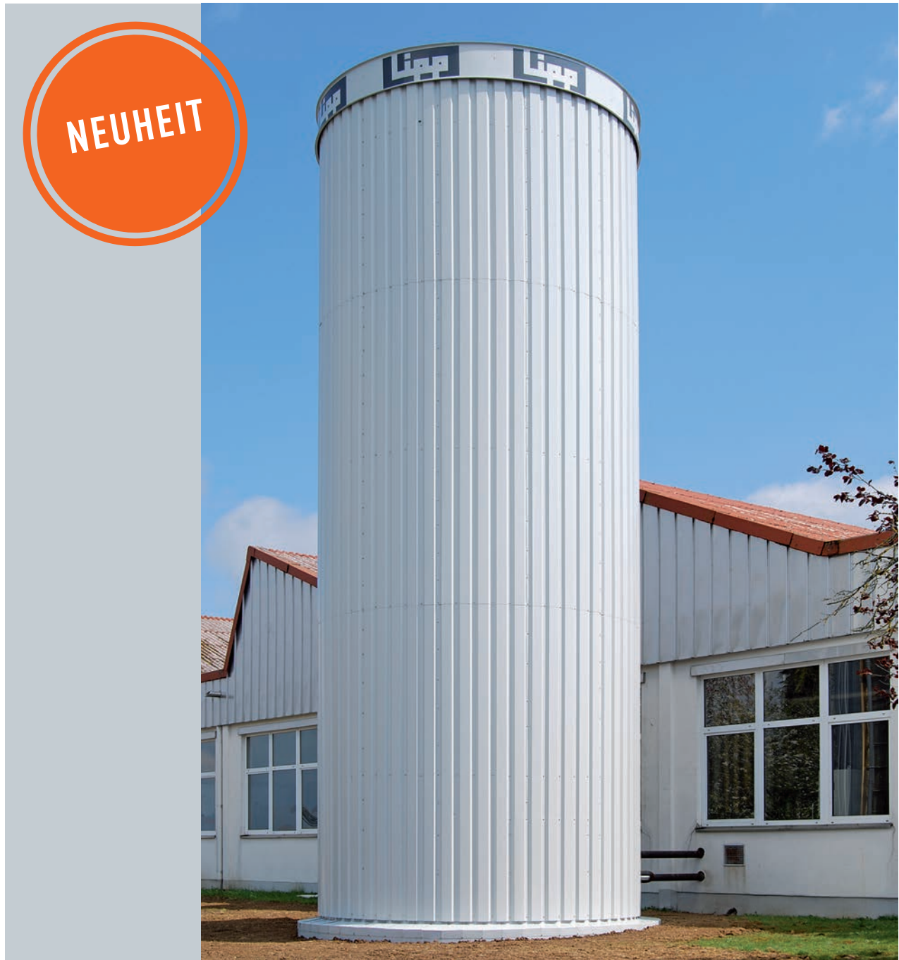
LIPP Pufferspeicher (100 m 3 Volumen) für Hallenheizung, angeschlossen an Biogasanlage über Fernwärmenetz
